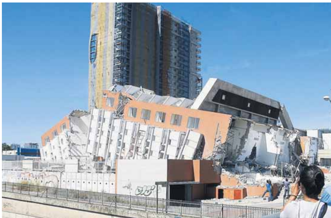
Atrás del edificio derrumbado se ve el que construye aún la inmobiliaria Paz.
