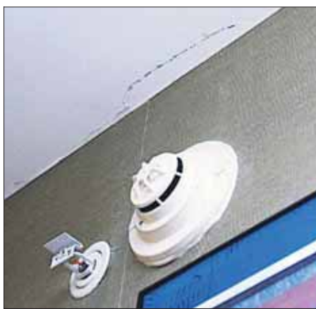
Esta pequeña grieta en la habitación de Arjona es indicio del terremoto en el Hotel «W».
