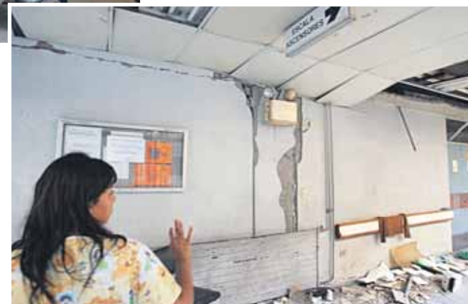
La directora interina muestra parte de los daños que dejaron inutilizable el hospital.
