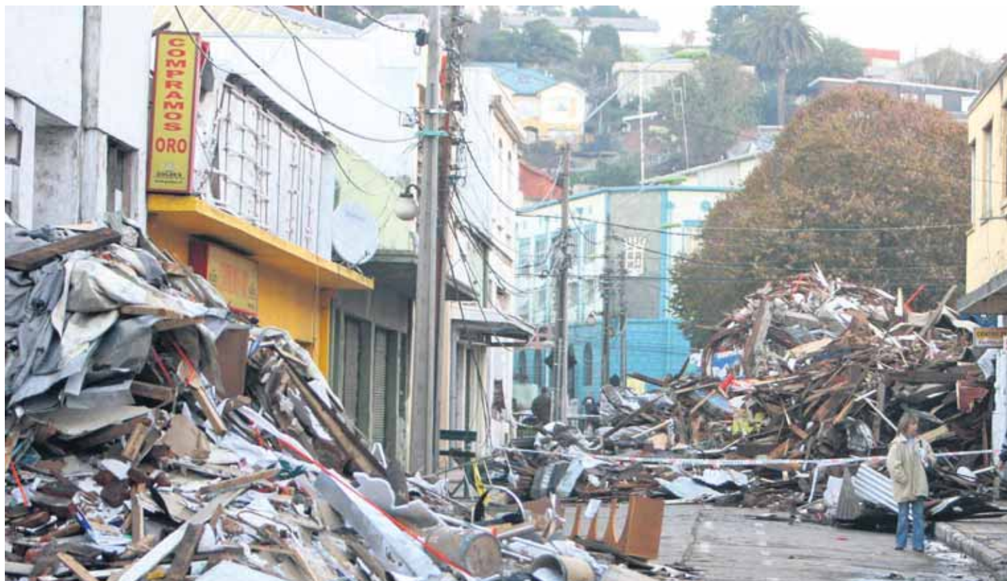
Los escombros volvieron a aparecer con fuerza en las últimas semanas, como en calle Bulnes, dado que los vecinos están demoliendo las propiedades dañadas, pero no retiran los materiales.
