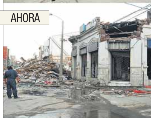
Al contrario, este tramo que hace un mes estaba abierto ahora se cerró por los escombros.
