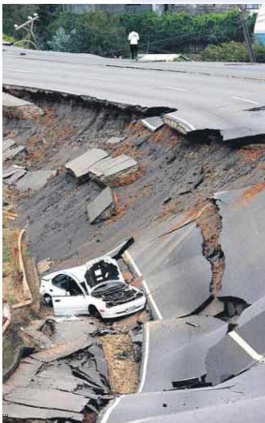
Gran socavón en la carretera que une Lota con Concepción, tras el terremoto del 27 de febrero.
