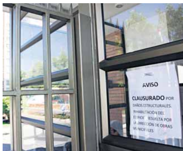
El edificio fue clausurado por el municipio.
