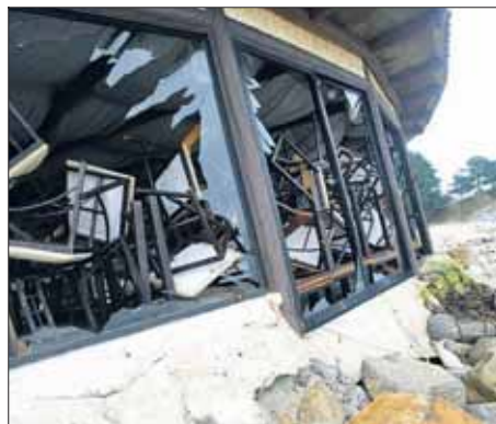
Totalmente destrozado quedó este restaurante.
