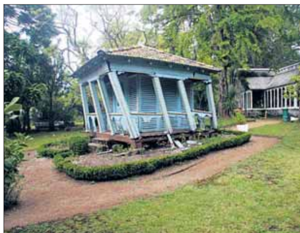
Uno de los primeros observatorios meteorológicos del país sufrió daños estructurales.
