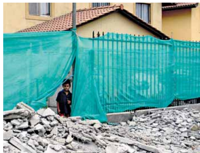
En una villa se derrumbó un muro medianero y por ahí se temía que ingresarán los ladrones.
